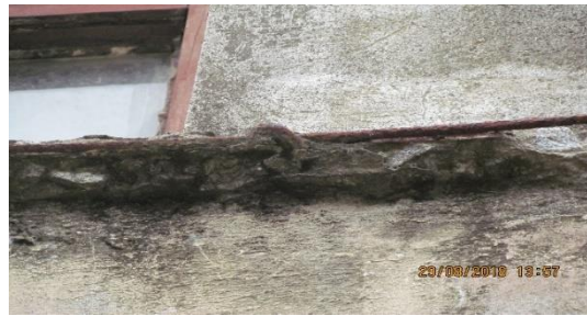
c) Daño en cornisa.
