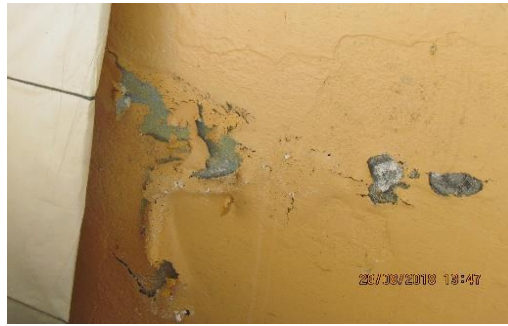
a) Daño Leve
