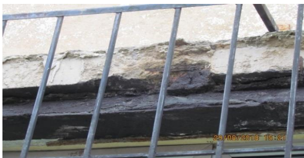
a) Daño en viga.
