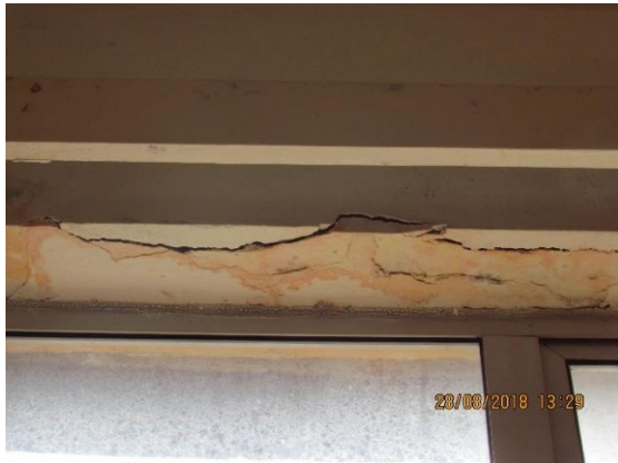
a) Daño en viga.
