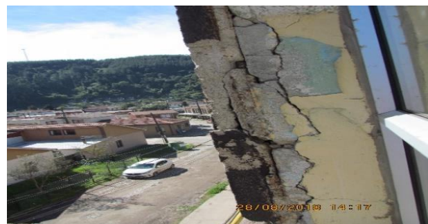
b) Daño en columna.
