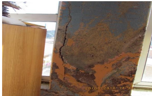
c) daño en columna.
