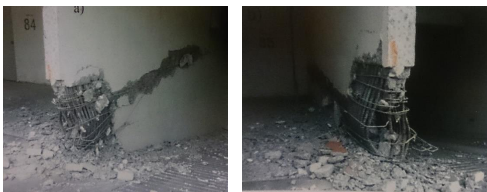
Figura 2.2: Muros reventados de un estacionamiento de un edificio de 17 pisos.
