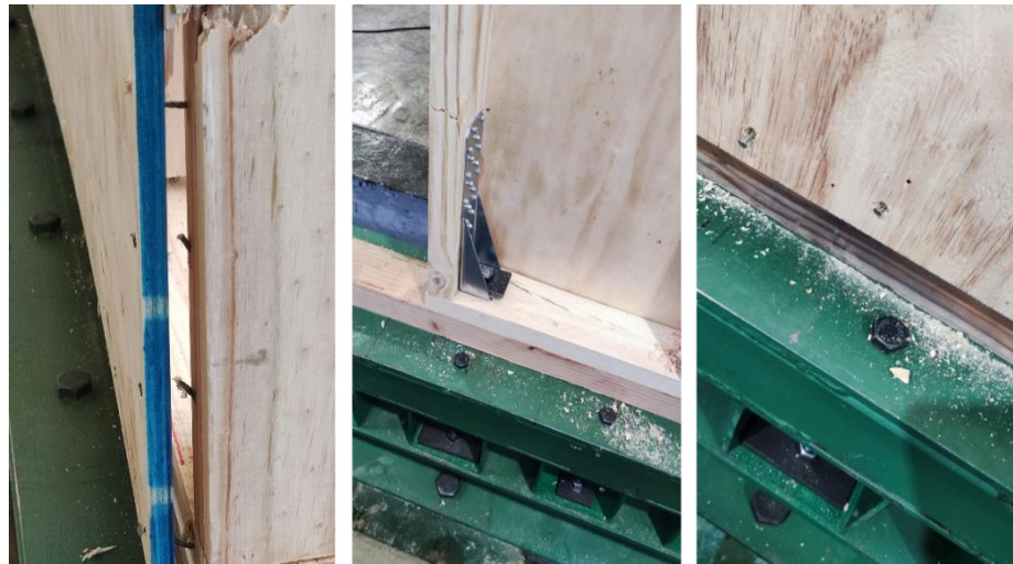
Figura n°4. Modos de falla Fuente: Elaboración propia
