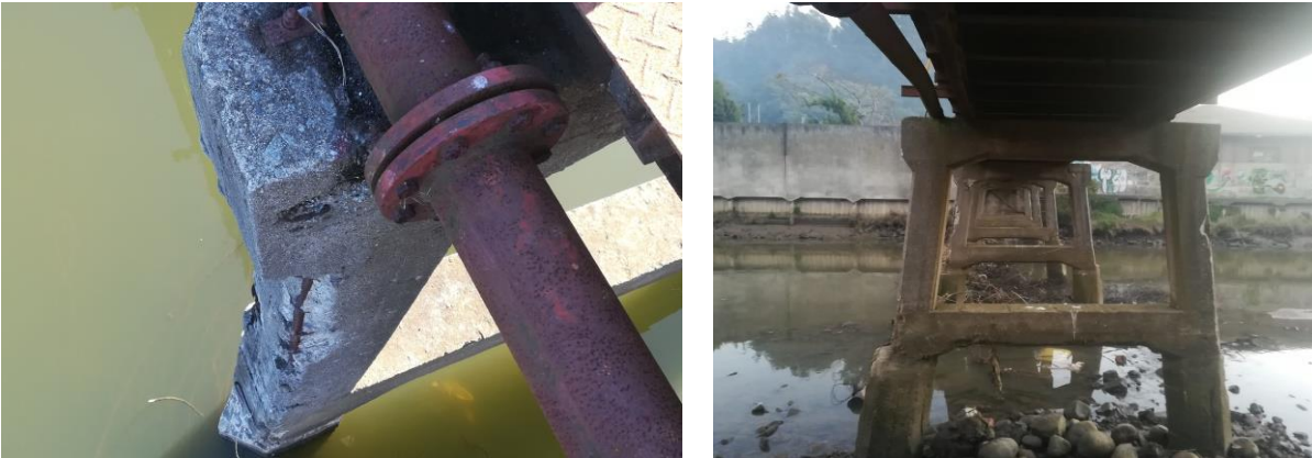
Fig.8: Daños en cepas
