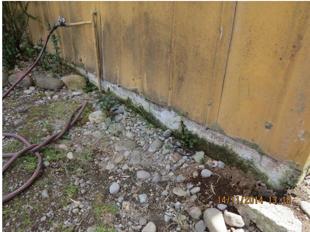
Figura 4: Asentamiento de terreno en patio trasero de una vivienda, localidad de Alerce, Puerto Montt.
