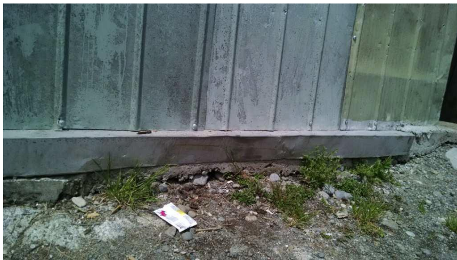
Figura 3: Asentamiento de terreno en patio de una vivienda, localidad de Alerce, Puerto Montt.
