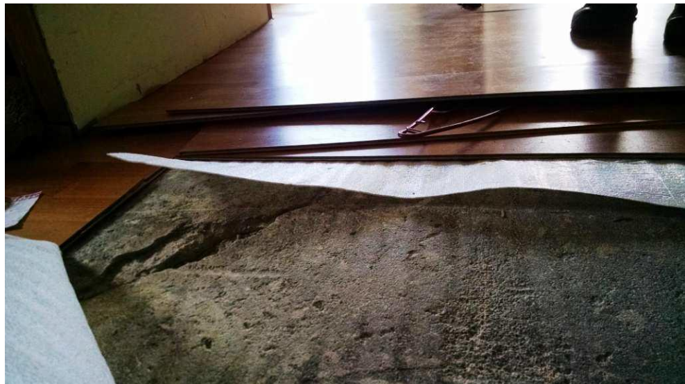
Figura 5: Agrietamiento de piso interior en vivienda debido al asentamiento de la base sobre la cual se apoya, localidad de Alerce, Puerto Montt.
