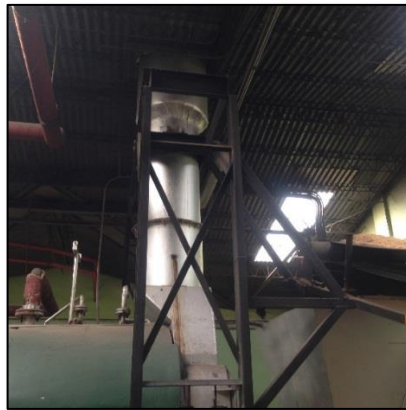
Figura 18: Chimenea de la caldera.
