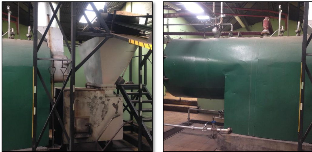
Figura 17: Caldera actual y estructura de alimentación de combustible.
