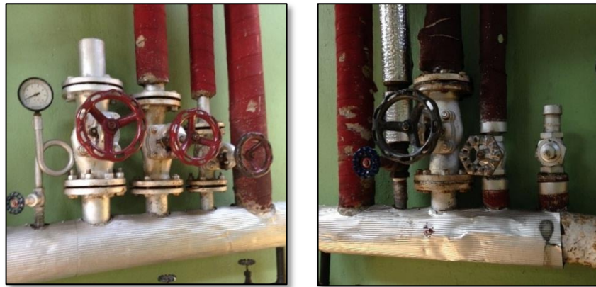
Figura 22: Llaves de paso para calefacción y lavandera.
