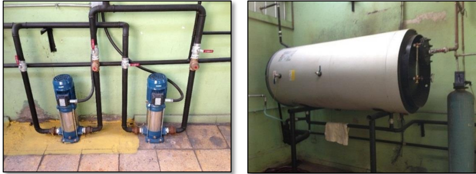
Figura 19: Bombas de inyección y estanque de condensado.
