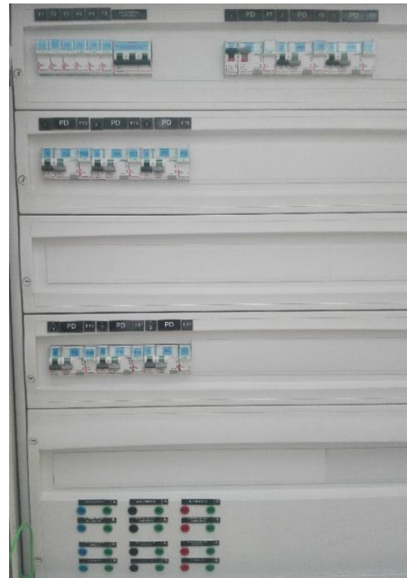
Fig. 5.7 Vista interior inicial de tablero inversores off grid. Fuente: Elaboración propia
