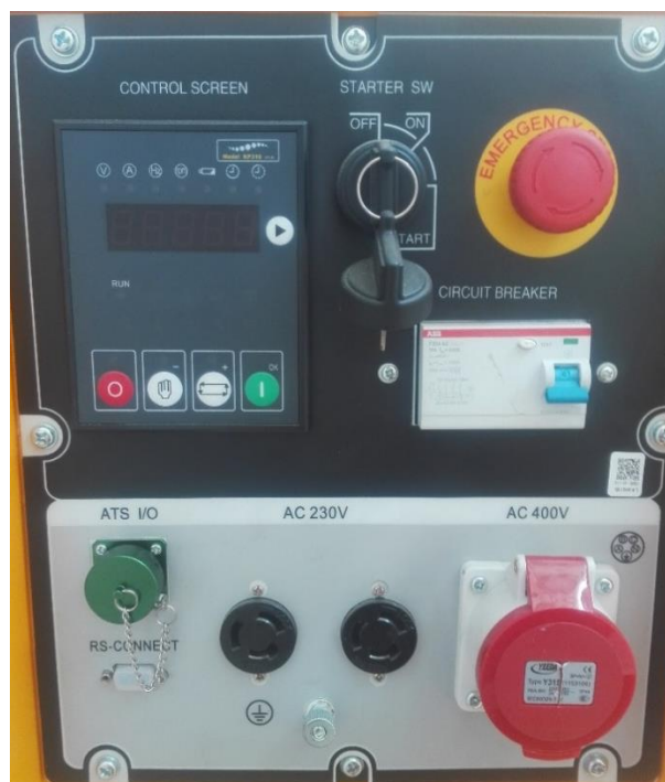
Fig. 3.14 Tablero de control y fuerza generador trifásico. Fuente: Elaboración propia
