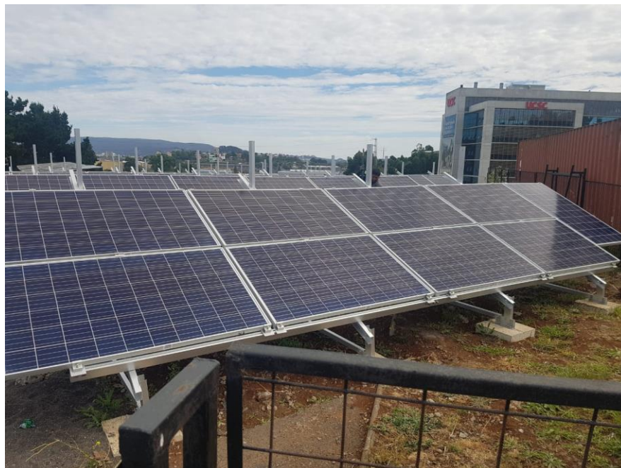
Fig. 1.2 Módulos fotovoltaicos instalados en patio MicroRed. Fuente: Elaboración propia
